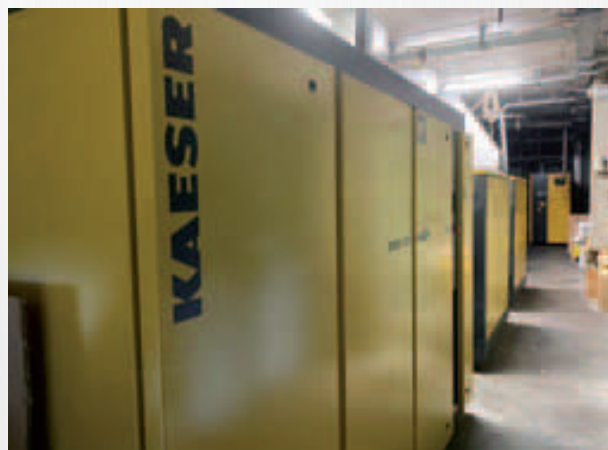
Vista della sala compressori, in primo piano la nuova unità da 160 kW, in fondo il nuovo essiccatore TG 650.
