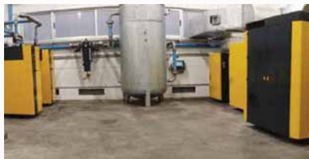
Sala compressori, fonderia.
