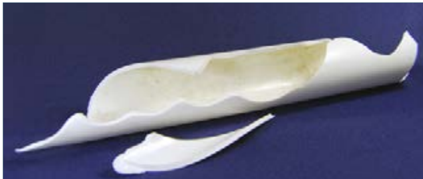
Rottura di una tubazione in PVC in un impianto ad aria compressa.
